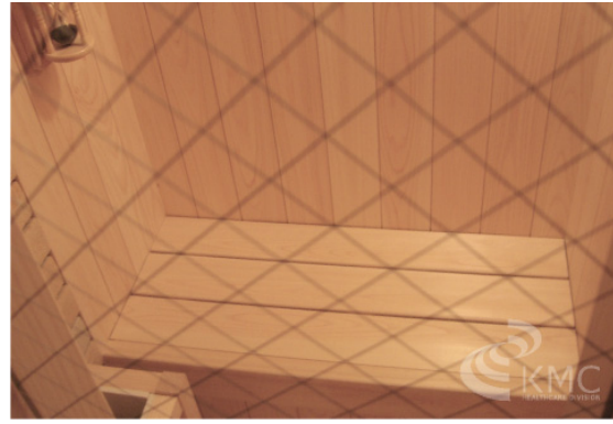
ガラス窓から見たサウナ室内
